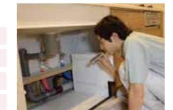
[キッチン配管の漏水確認]
