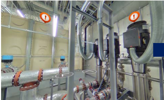
「受水槽室」の設備を説明。
